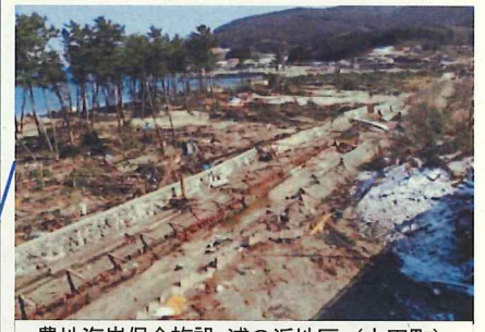
農地海岸保全施設 浦の浜地区(山田町)堤防L=412m全壊
