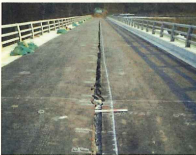
農地防災ダム 衣川1号ダム(奥州市)の堤頂部亀裂
