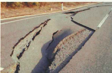
広域農道整備 西磐井地区(一関市)の亀裂、陥没
