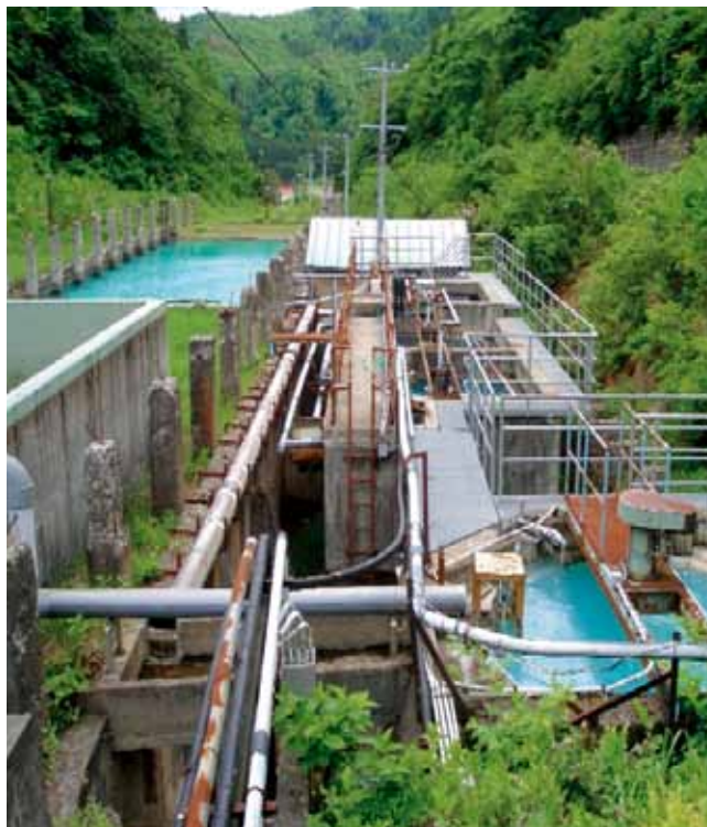
吉乃鉱山（横手市）坑廃水処理施設
