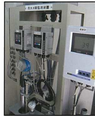
モニタリング設備
