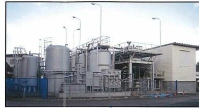
新水処理施設
