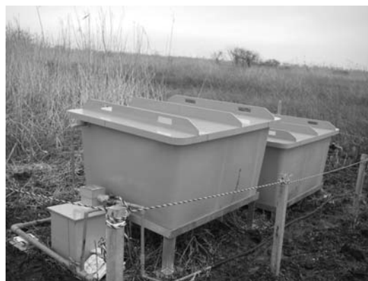
図2 フィールドに設置したリン除去・回収装置
