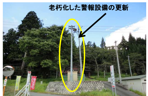
警報設備改良 [旭川ダム(秋田市)]
