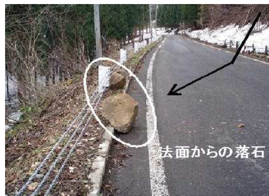
○法面对策[鳥海矢島線笹子峠工区] (落石の状況)
