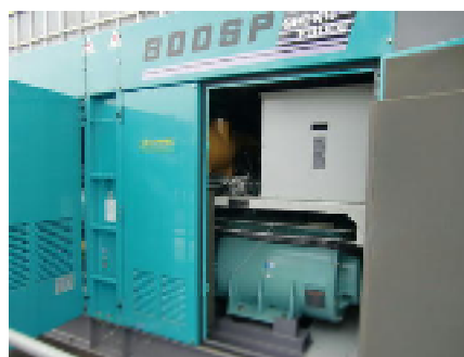
工場の発電設備の整備
