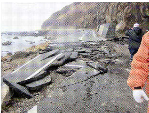
男鹿半島線被災状況
