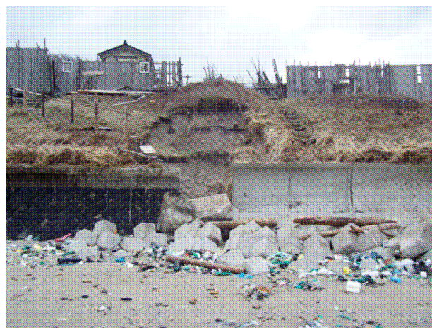
本荘海岸（松ヶ崎）の被災状況
