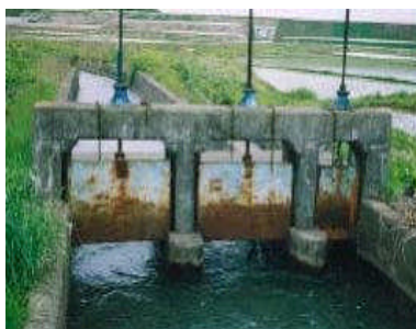
幹線水路取水ゲートの劣化 （県担当課室名
