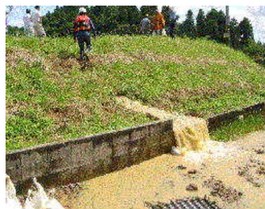
老朽化したため堤体からの漏水 農林水産部農地整備課）
