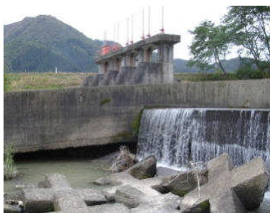
頭首工の堰堤洗掘
