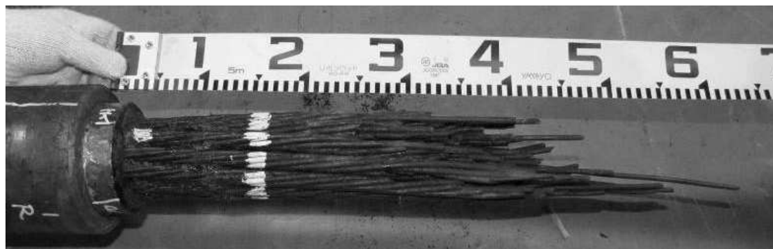
写真-4 ケーブル破断箇所のPC鋼より線
