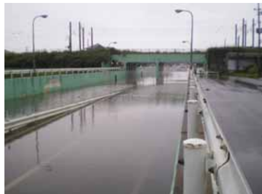
アンダーパスの冠水事例
