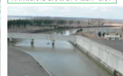
中央幹線排水路(排水機場から堤防外へ排水)
