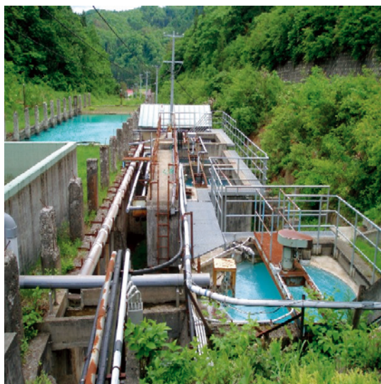
吉乃鉱山（横手市）抗廃水処理施設
