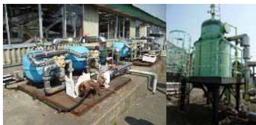
アワビ種苗生産施設 （左：循環ろ過設備、右：ガスセパレーター）
