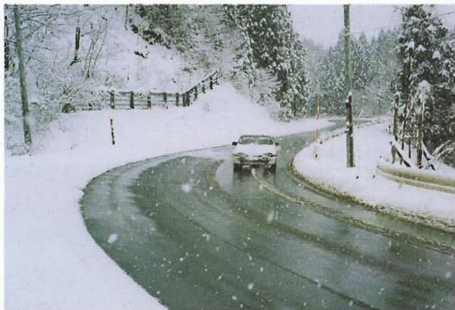
ロードヒーティング（国道105号 鷹巣町）
