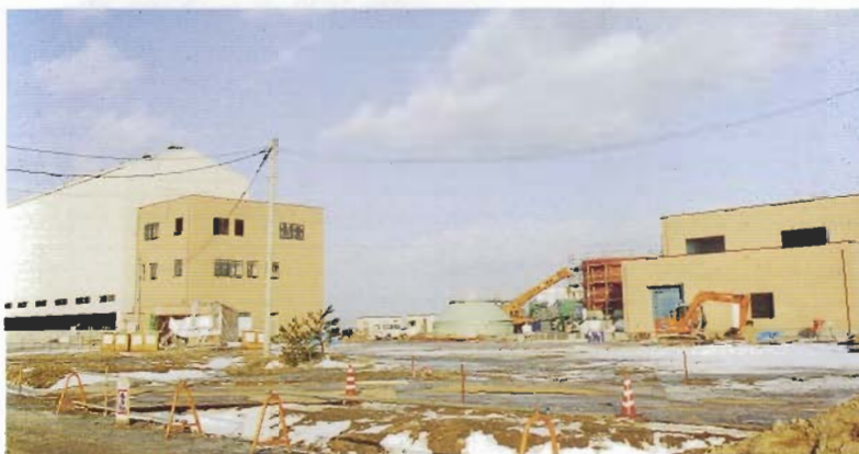
秋田県流域下水道汚泥焼却施設 平成11年10月供用開始予定
