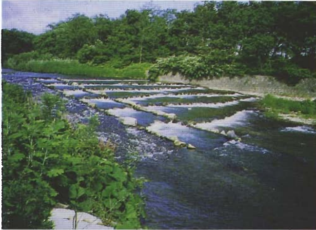
魚の遡上を考慮した魚道 (水沢川・峰浜村)
