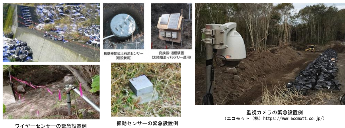
図 2-12 監視観測機器の緊急設置例
