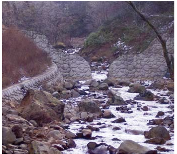
外面の化粧と上下流の連続性確保により、十和田八幡平国立公園内の景観と環境に配慮した砂防えん堤。 (仙北市・先達川)
