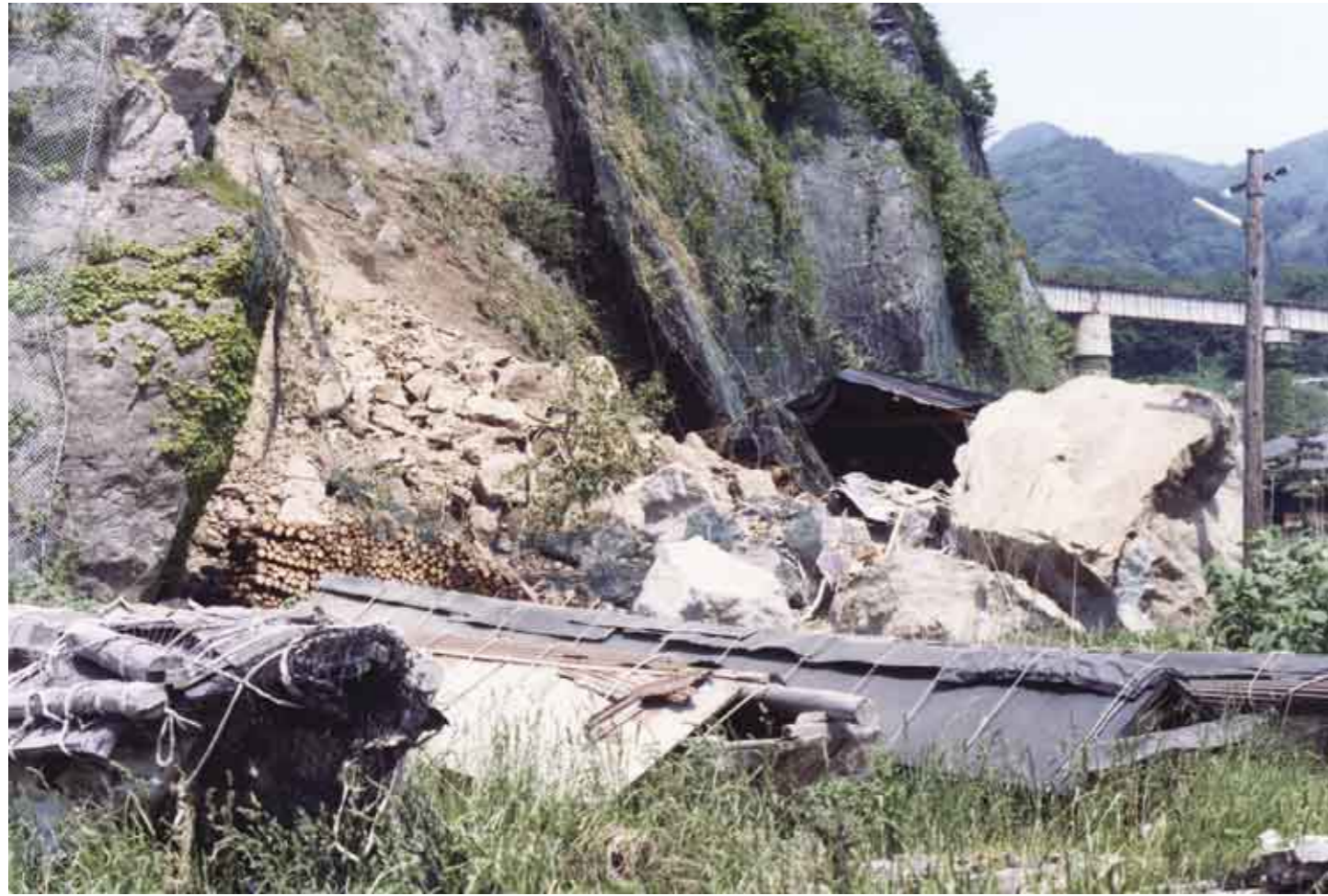
山本郡八森町小入川地区／観光地になっている岩館海岸のガケが崩れた。
