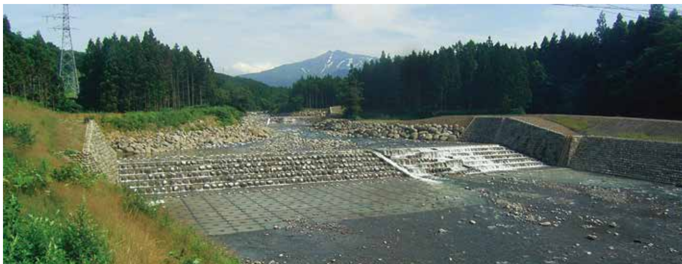
にかほ市 白雪川床固工(現地発生材の利用・魚道の設置)
