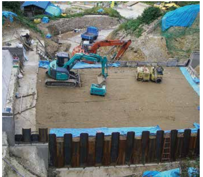
コンクリートを出せる限り使わず、現地発生土を内部に詰めた砂防えん堤。(横手市・沼山沢川)
