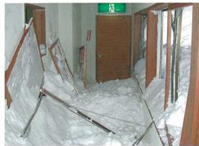
白骨地区表層雪崩災害(長野県松本市(旧南安曇郡安曇村)平成14年1月28日) 大規模な表層雪崩の発生により、直下の旅館に被害が発生した。次期降雪期の雪崩により被害を受ける恐れがあるため、災害関連緊急雪崩対策事業により緊急的に雪崩防止工事を実施。
