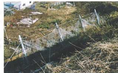
スノーネット 雪崩の発生を未然に防ぐための施設で、周辺の自然環境に配慮し、景観性・施工性に優れています。 Snow Net Snow Nets blend in well with natural scenery yet are quite effective.
