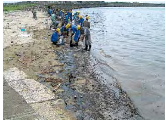
○水質事故の現場
