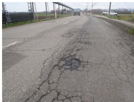
舗装補修予定箇所
