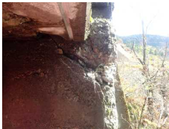
太良橋 破損状況
