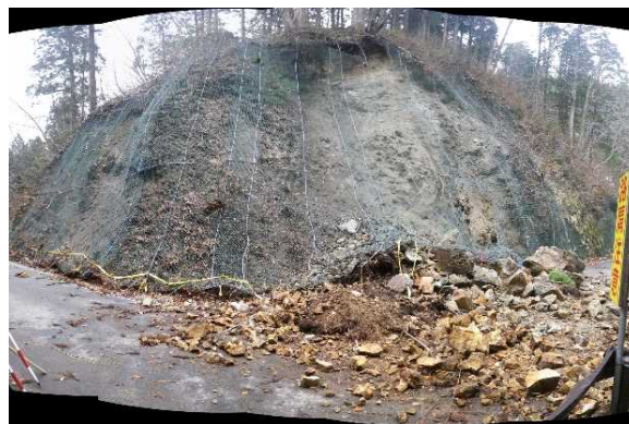
西目屋二ツ井線（落石状況）
