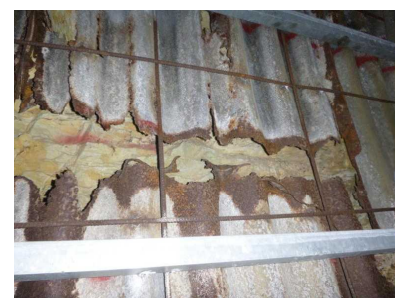
鋼材腐食状況
