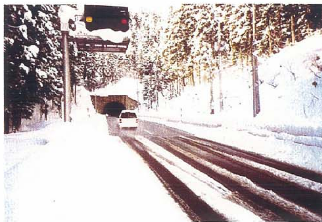
ロードヒーティング（国道285号 大館市）
