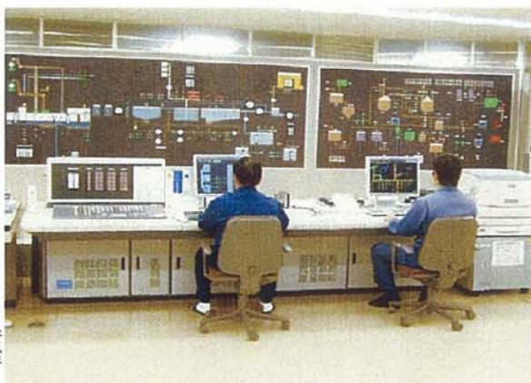
中央流域下水道事務所 中央監視室
