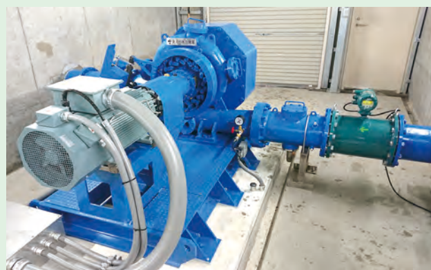
実証機（鎧畑発電所3号機）
