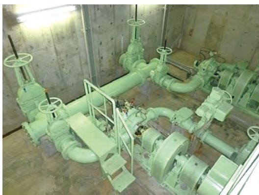
御所野系送水ポンプ
