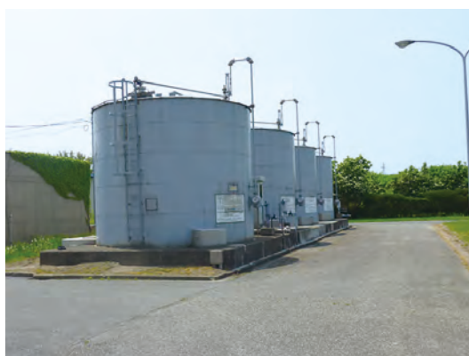
浄水用薬品タンク
