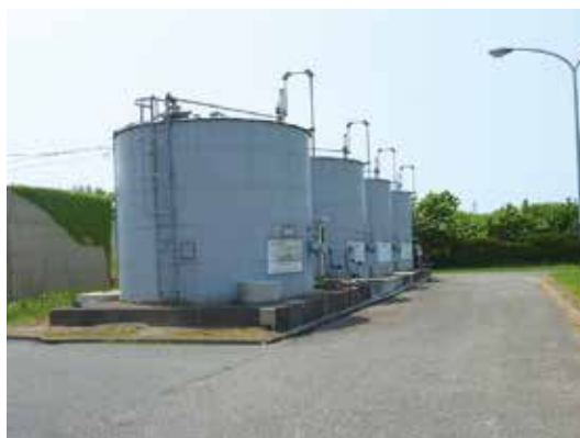
浄水用薬品タンク
