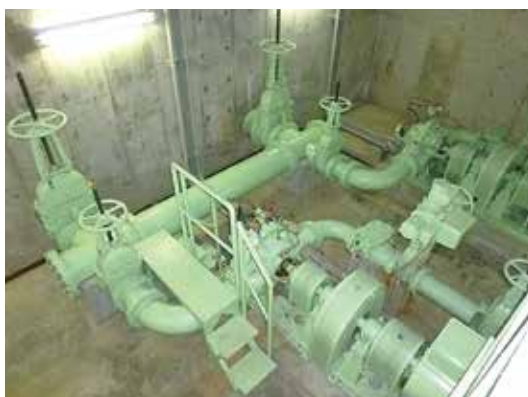
御所野系送水ポンプ
