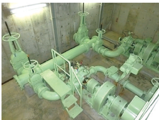
御所野系送水ポンプ
