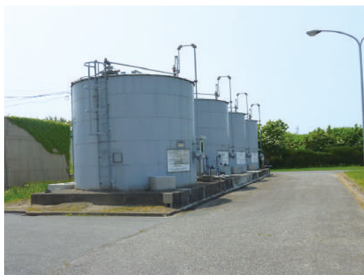
浄水用薬品タンク
