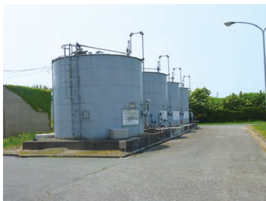
浄水用薬品タンク
