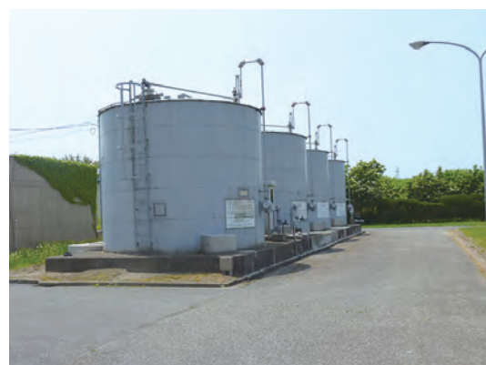
浄水用薬品タンク
