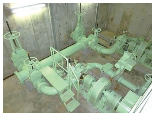
御所野系送水ポンプ
