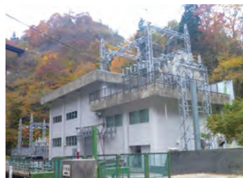
素波里発電所
