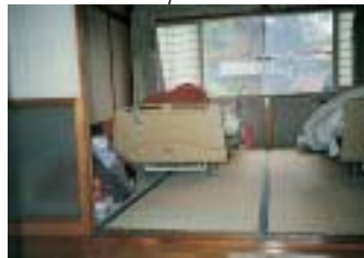
寝室 敷居段差
