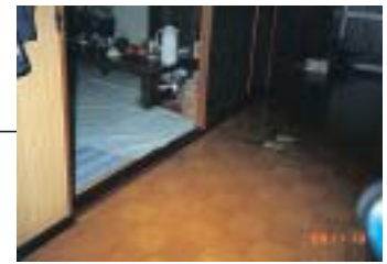
ローカ～居間 敷居段差
