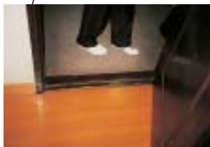
居間～ローカ 敷居の段差
