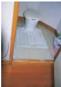
トイレ 入口の段差が車イスを便器に近づけないようにしていた
