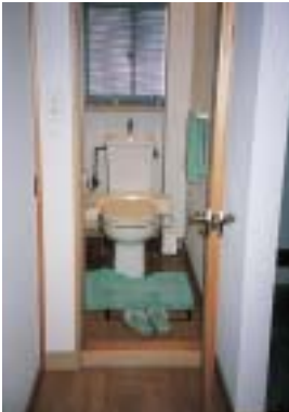
2F トイレ 段差が大きい
