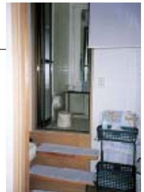
2F浴室～脱衣室 お風呂へ入るためには3段の階段を昇る
