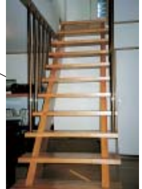
ホール～2階居室へ行く階段 毎日ここを昇り降りするが手すりはにぎるとクルクル回る
