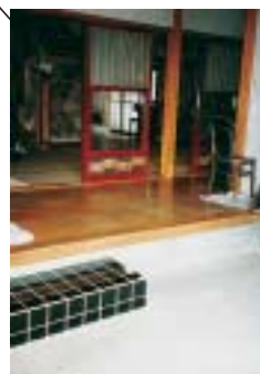
玄関～ホール 土間からホール床まで かなりの段差あり
