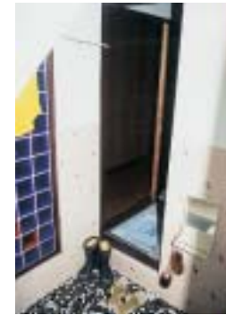
改修前 浴室 出入口に手すりが欲し い。
