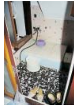
改修前 浴室 浴槽の出入りに手すりが 欲しい。シャワー水栓のつ まみが、ツーバルブで面倒。
