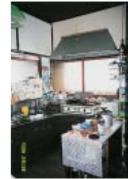
改修前 キッチン 4.5帖の狭いところに物 がたくさんあるので動き もできない。 流し台は、大工事で造っ た古いものなので傷んで きている。
