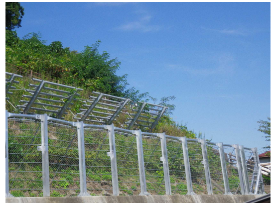
柵工（雪崩防護柵）
