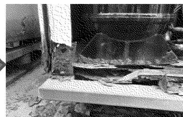
室外機内部腐食状況
