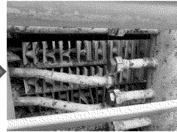
冷却塔コイル破損状況
