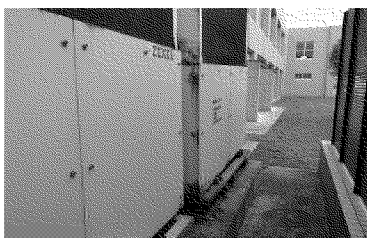
冷暖房室外機 現況
