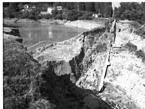
豪雨災害によるため池決壊 (H25.9月 台風18号:男鹿市)
