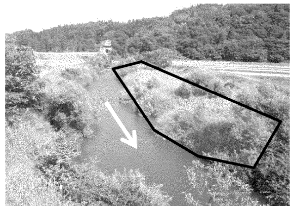
県単河川等環境維持修繕事業 石沢川（由利本荘市） 河道掘削
