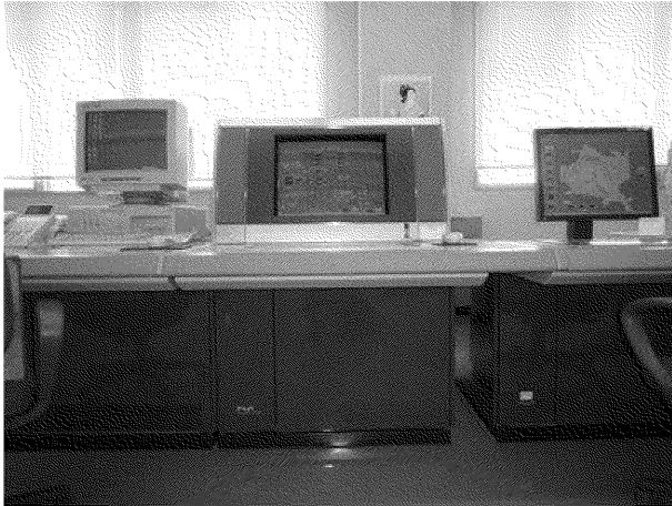
○横手処理区[監視制御設備]
