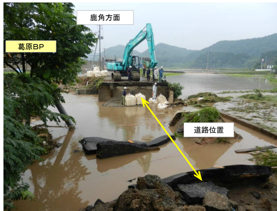
被災状況 (8月9日(金) 16時頃)
