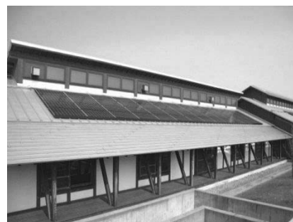
太陽光発電システム
