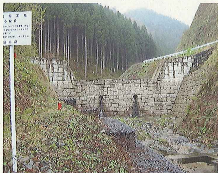
《災害時要援護者施設(老人福祉センター)を 保全する砂防えん堤大館市・小雪沢》
