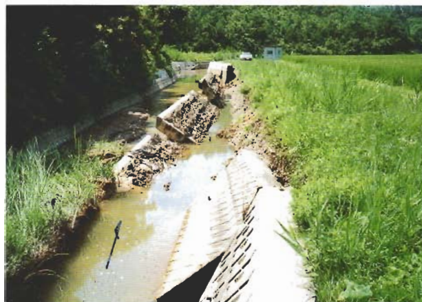
被災状況写真
