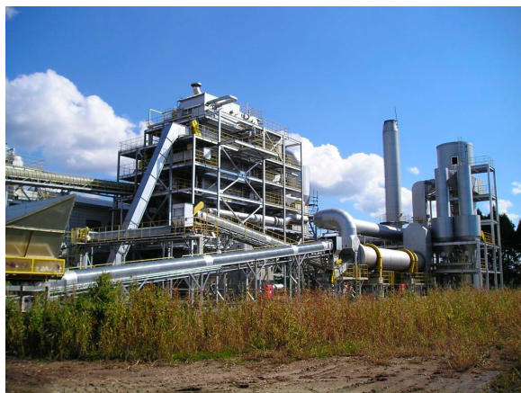
能代バイオマス発電所
